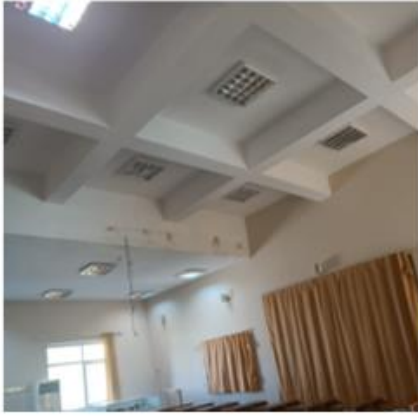
Sınıf problemlili aydınlatma sistemi
